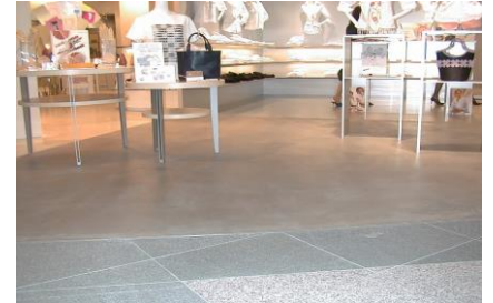
店舗床劣化防止
