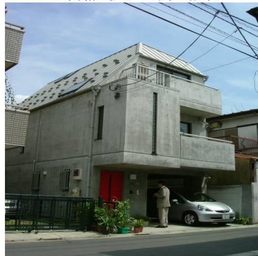
住宅外壁クリスタルストーンNR処理 8年経過
